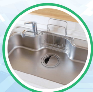
キッチンの排水管
